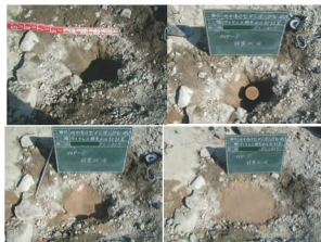
Fig.16 半透水性ゾーンにおけるワイヤレス間隙水圧計の設置状況
